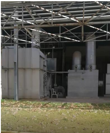
一分厂焚烧炉
